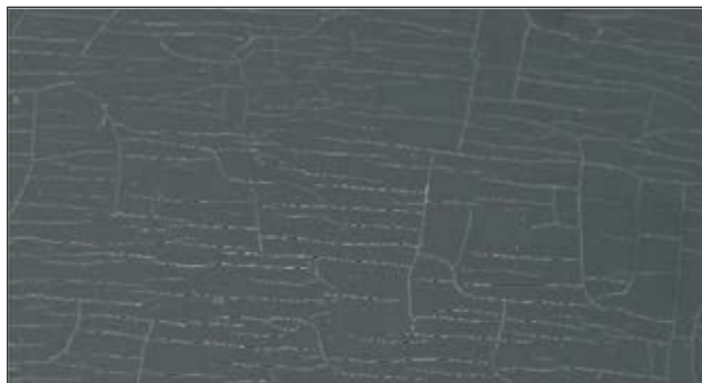
Îmbinare a fost deteriorată de radiația UV.
